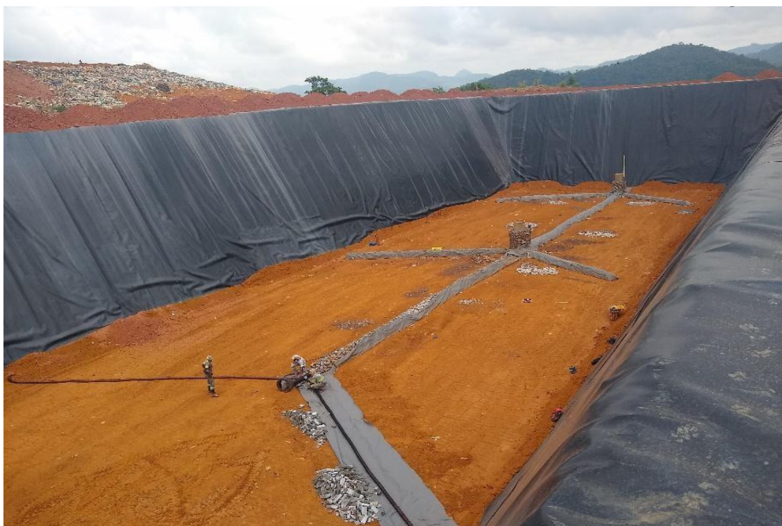
Construção do sistema de drenagem com elevação de dreno para captação de chorume e saída para gás.
